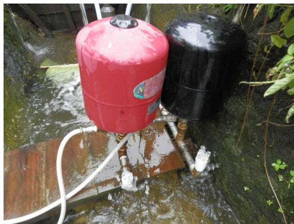
Gambar 9 Pompa hydram yang terpasang di lokasi
